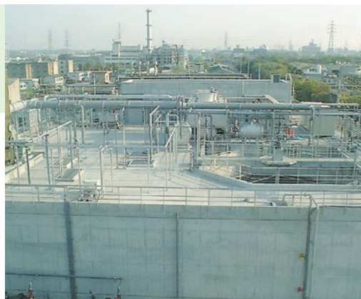
ダイセキ名古屋事業所の活性汚泥処理施設
