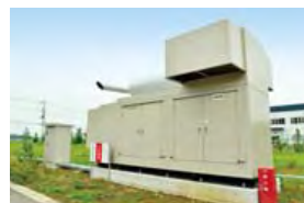
停電に備えて非常用発電機を設置
