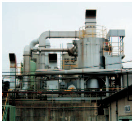
燃焼脱臭装置
