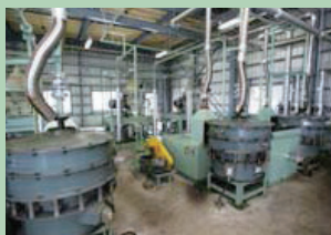
廃油処理(振動ふるい機)
