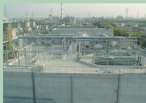
活性汚泥処理施設
